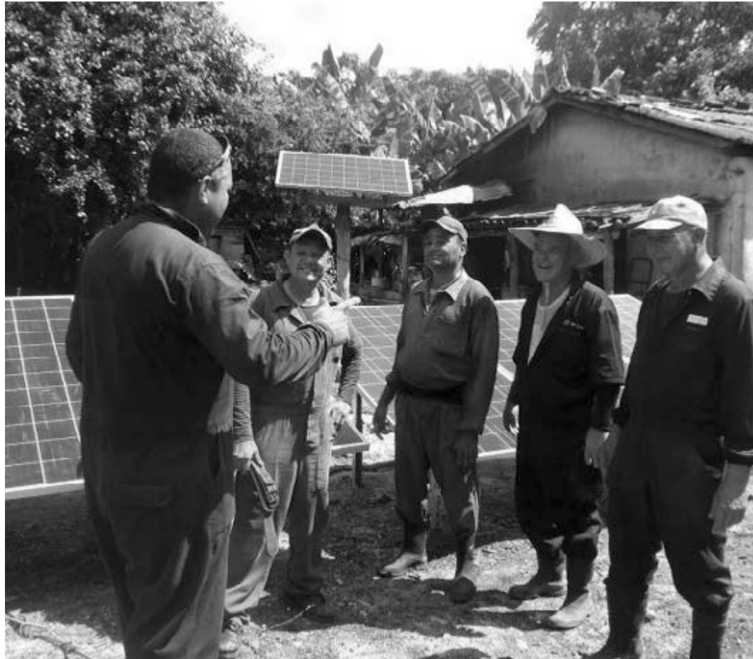
Das Team installiert in der Regel ein Panel pro Tag, manchmal aber auch zwei oder sogar drei FOTO: PASTOR BATISTA
