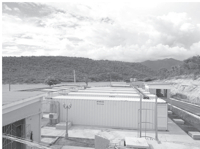
Die Errichtung der fünf Linien der Entsalzungsanlagen erforderte diverse begleitende Baumaßnahmen FOTO INRH
