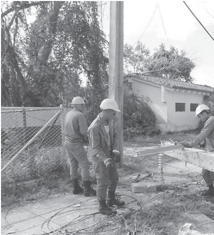
Dank intensiver Arbeit konnte die Stromversorgung bereits zu 99,9 % wiederhergestellt werden
