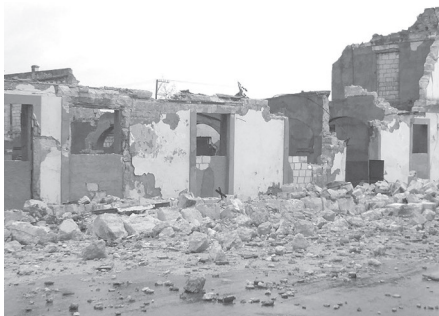
Zerstörte Häuser in Matanzas
