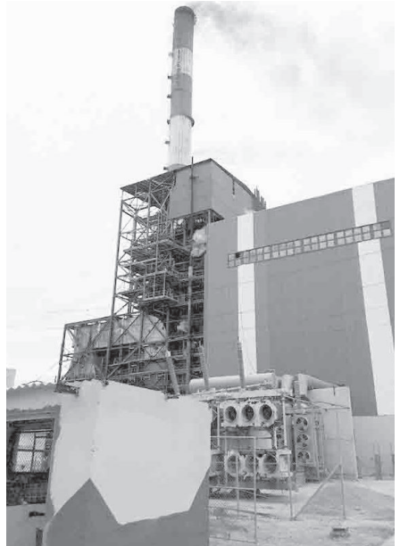
Das stark beschädigte Wärmekraftwerk Antonio Guiteras in Matanzas konnte am 27. September wieder angefahren werden
