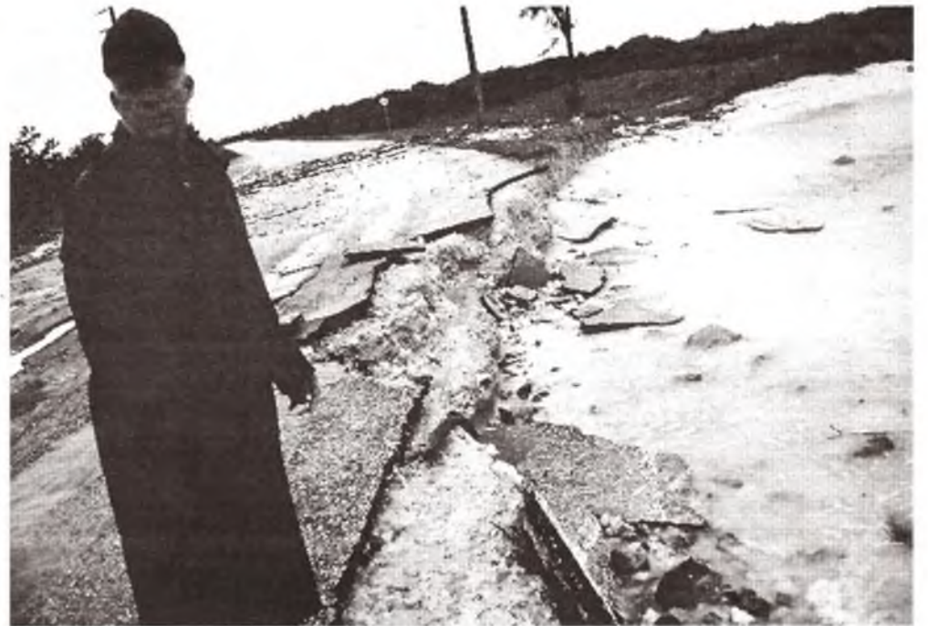
Eine beschädigte Straße in der Provinz Las Tunas
