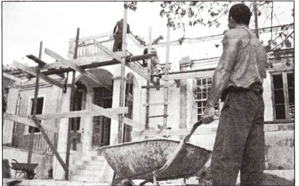
Das Haus hatte weder Fenster- und Türsturz, noch Verschlüsse, wodurch die Reparatur erschwert wird
