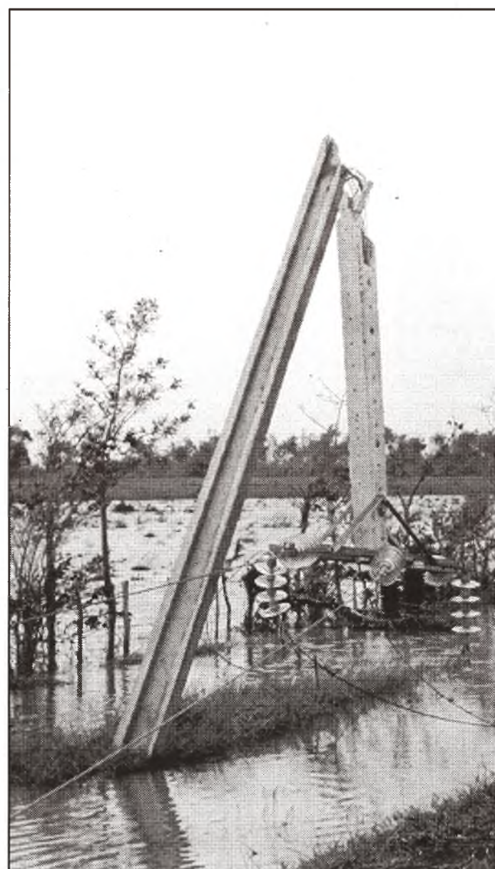
Dieser Betonmast brach in der Mitte entzwei
