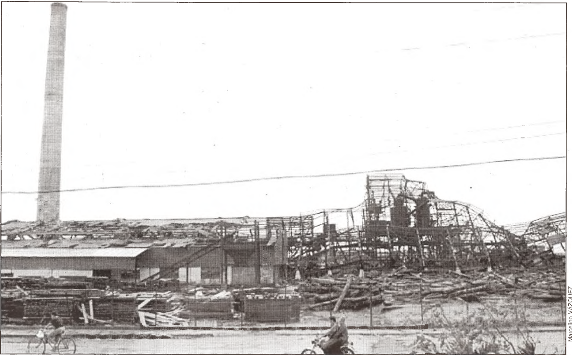
Die Zuckerfabrik Australia in Jagüey Grande, Provinz Matanzas, erlitt beträchtliche Schäden in ihrer Metallstruktur
