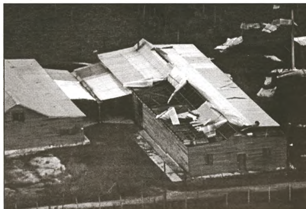
An vielen Wohnhäusern, Tabakhäusern und anderen Einrichtungen wurden die Dächer vom Sturm stark beschädigt
