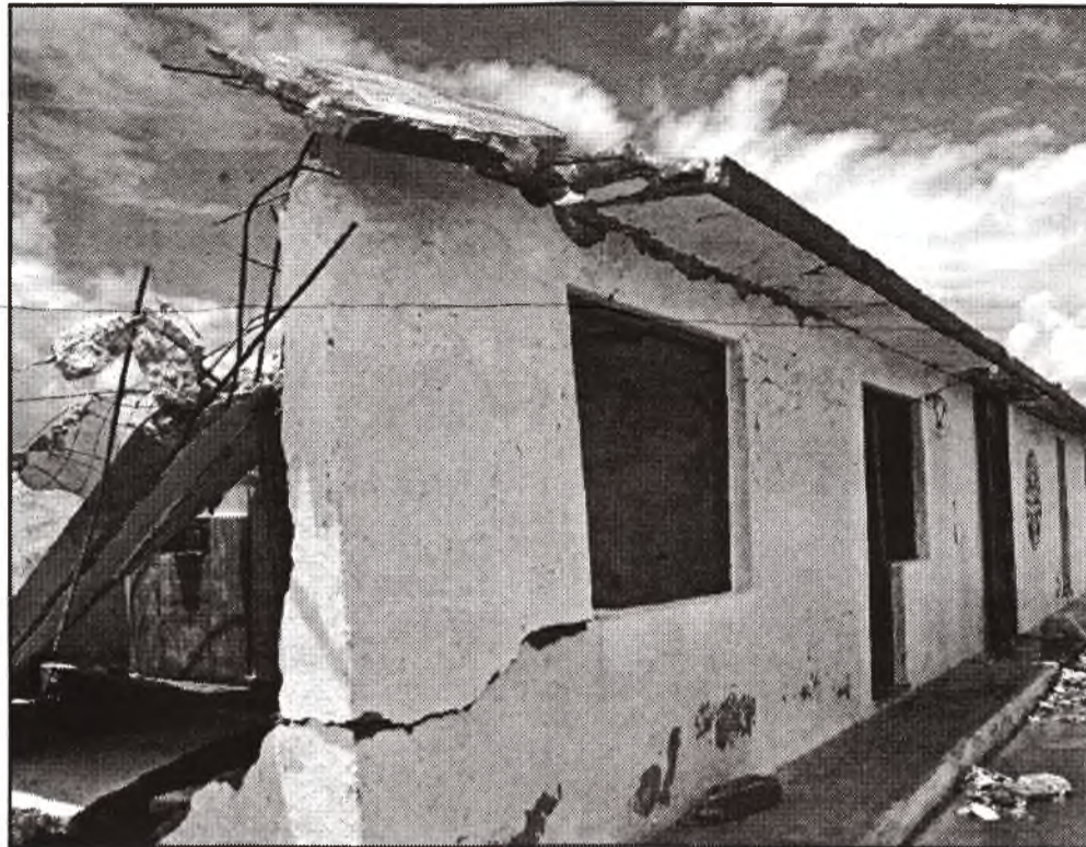
In Cajío entstanden an allen Häusern große Schäden
