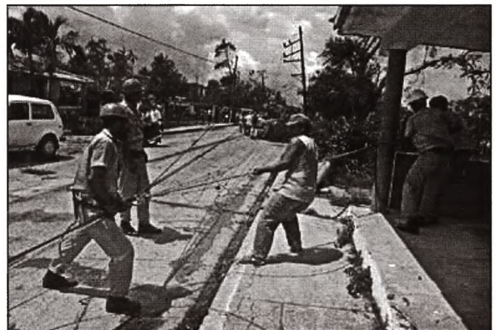
Sonderbrigaden aus dem ganzen Land helfen bei der Beseitigung der Sturmschäden
