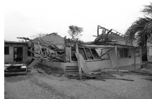
Schäden durch „Irma“ auf Kuba
